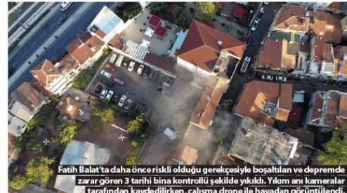
Fatih Balat'ta daha önce riskli olduğu gerekçesiyle boşaltılan ve depreme zarar gören 3 tarihi bina kontrollü şekilde yıkıldı. Yıkım anı kameraları tarafından kaydedilirken, çalınma drone ile havadan görüntülendi.
