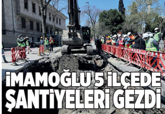
İBB Başkanı Ekrem İmamoğlu, pandemi süreci nedeniyle uygulanan 4 günlük sokağa çıkma yasağında masasına oturdu. İmamoğlu, Bakırköy, Şişli, Beşiktaş, Kadıköy ile Üsküdar'daki şantiyeler ve meydana gelen çalışmalar hakkında bilgi verdi.
