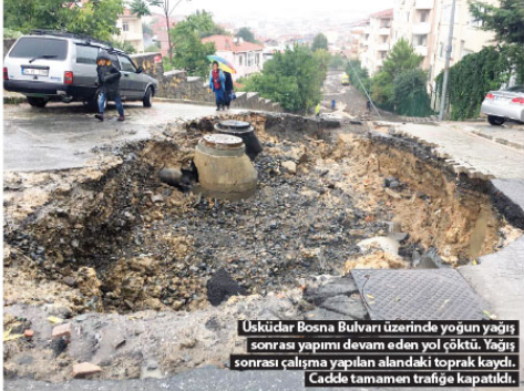
Üsküdar Bosna Bulvarı üzerinde yoğun yağış sonrası yapılmı devam eden yol çöktü. Yağış sonrası çalışma yapılan alandaki toprak kaydı. Caddede tamamen trafige kapatıldı.
