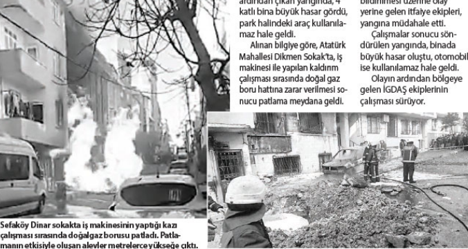
Sefaköy Dinar sokakta iş makinesinin yaptığı kaz çalışması sırasında doğal gaz borusu patladı. Patlamanın etkisiyle oluşan alevler metrelerce yükseldi.
